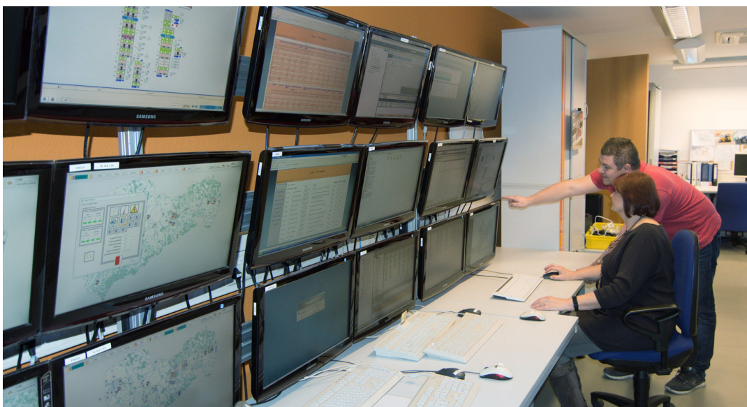
Vom Leitstand in Dresden aus hat das Team der Fachstelle für Informationstechnik einen Überblick über die gesamte IT- und Verkehrstechnik im Land und kann im Fehlerfall alle Reparaturarbeiten zentral koordinieren.
